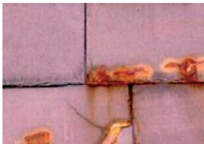
Figur 2. Nedbrydning af skifer med for stort jernindhold. Skaden kunne være undgået, hvis stenene havde været kvalitetsprøvet med fortyndet saltsyre inden oplægning.
